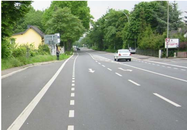
Schutzstreifen auf überbreiter Fahrbahn im Übergangsbereich zur Ortslage
